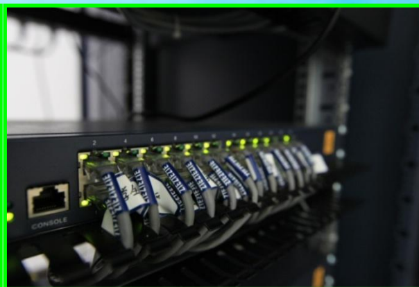
基础通信实训室
